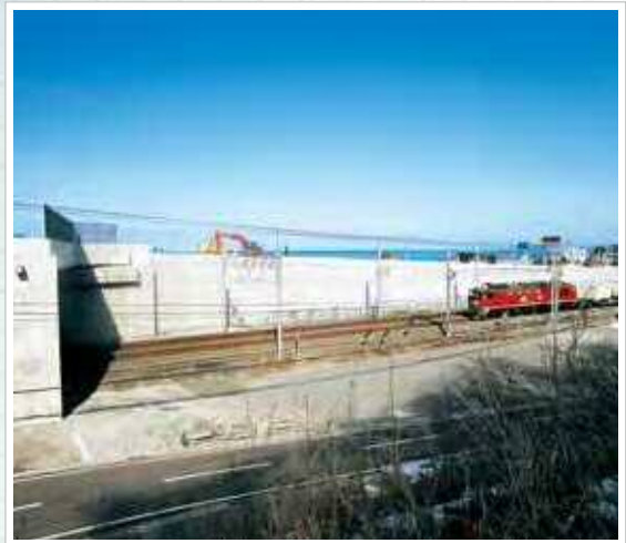
施主：国土交通省高田河川国道事務所 工事名：能生大橋付替道路他工事 概算壁面積：960㎡
